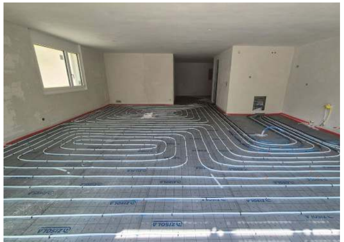
Fussbodenheizung bei der Geschäftsstelle
